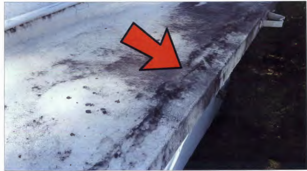
Roof edge separating
